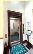
●エレベーター
